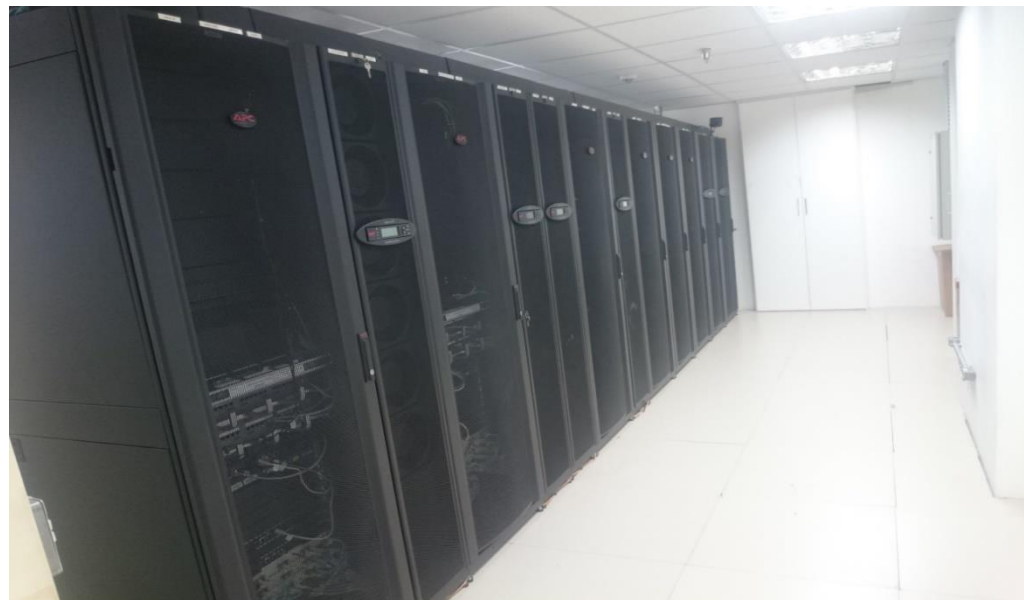
Sala de Infraestrutura Física de TI da SEFAZ/ES (Central telefônica, nobreaks, chegada do cabeamento vertical e horizontal, servidores da inteligência)- Corredor de Ar Frio
